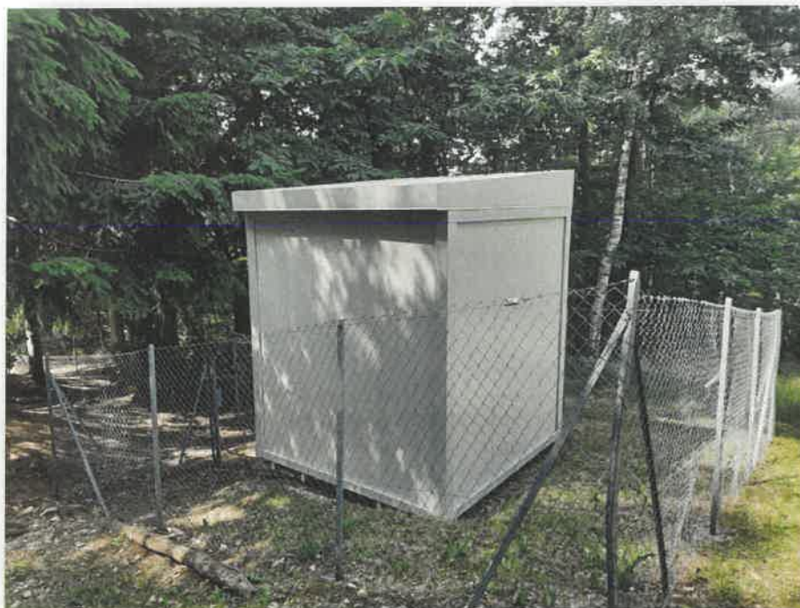
Figura 12 - Cabina contenente il filtro arsenico esistente, da ricollocare a monte del nuovo serbatoio
