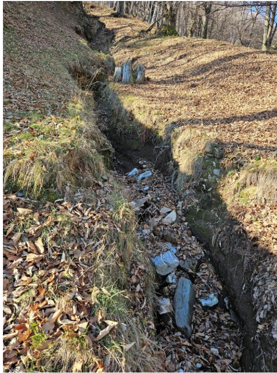
Foto 3: zona d'erosione lungo l'ova a monte del travaccone
